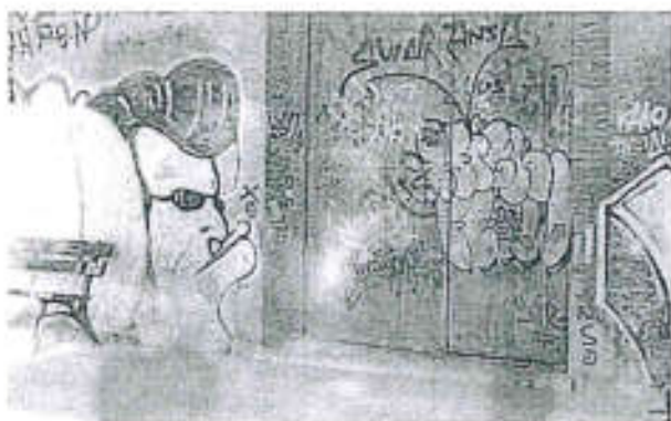
Εικόνα 13: Αλλοιώσεις λόγω γκράφιτι
