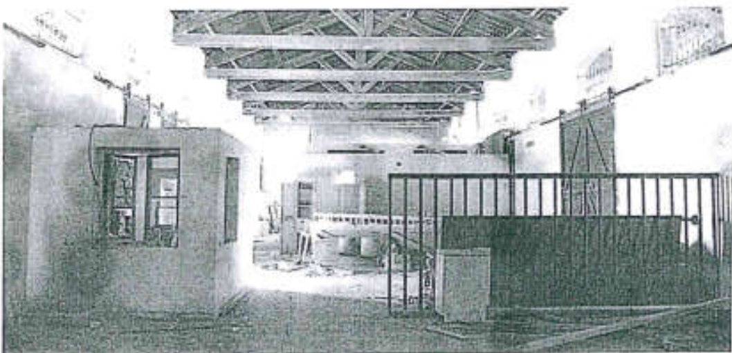
Εικόνα 12: Αττική εσωτερικού χώρου, στο βάθος διακρίνονται οι Η/Μ χώροι του ΟΣΕ
