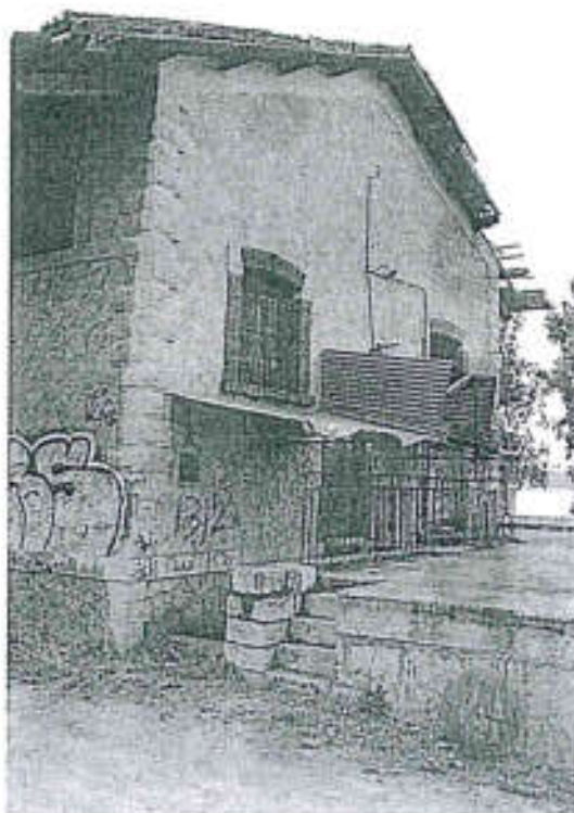
Εικόνα 15: Πρόχειρη κατασκευή από λαμαρίνα - Στην φωτογραφία φαίνεται και η φθορά της στέγης
