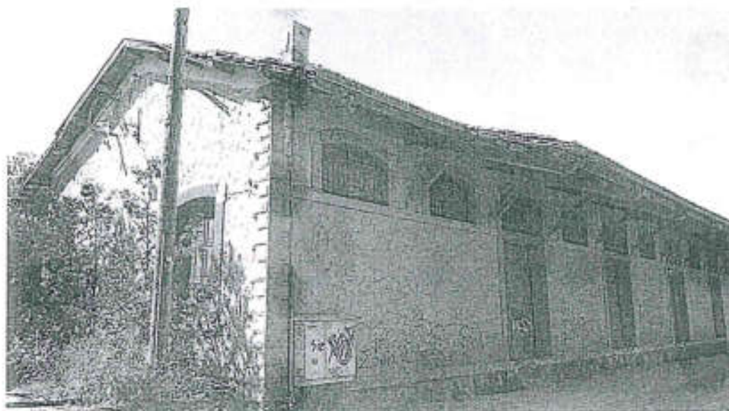
Εικόνα 24: Κατάρρευση τμήματος επικεράμωσης στο ανατολικό τμήμα της στέγης.
