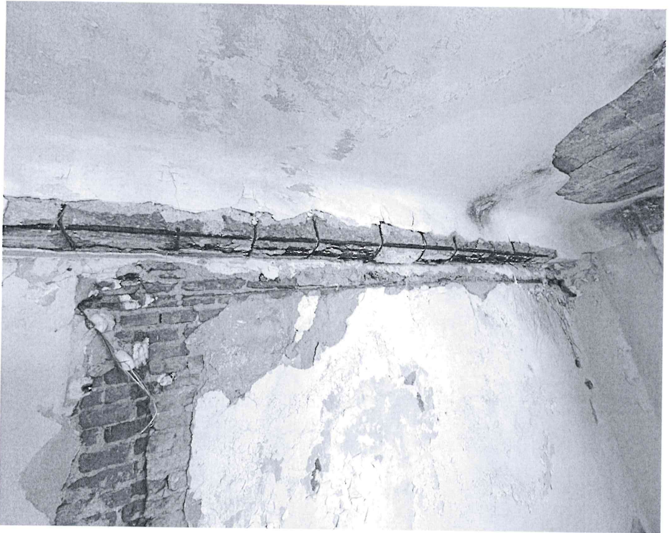
Εικ. 23: Δοκός (που αποτελεί κρίσιμο δομικό στοιχείο) με πλήρη αποκόλληση της επικάλυψης του διαβρωμένου πλέον σπλισμού και απομείωση της διατομής της
