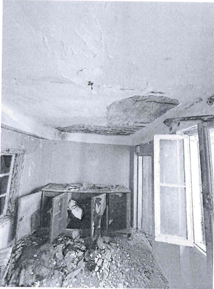
Εικ. 24-26: Αποκόλληση επικάλυψης σπλισμού πλακών οροφής και συνέχιση διάβρωσης του σπλισμού τους
